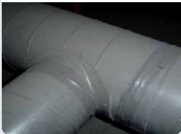
Photo 5 : Conduits étanches en combles
