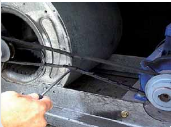
Photo 3 : Courroie ventilateur en mauvais état
