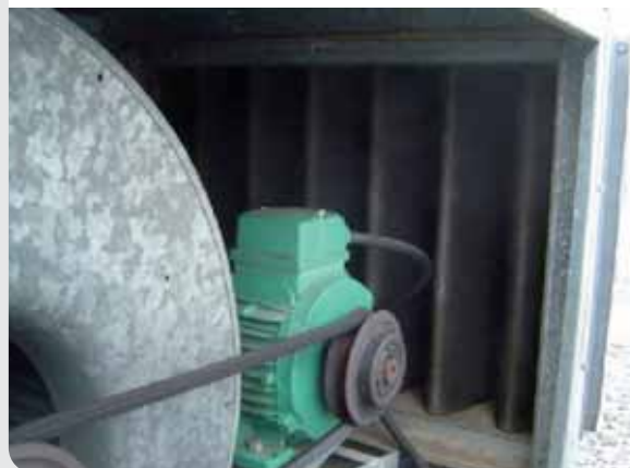
Photo 4 : Intérieur CTA avec filtre à air
