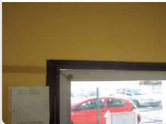
Photo 14 : Porte fenêtre non étanche à l'air (jour visible)
