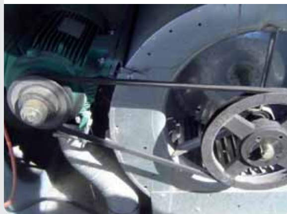
Photo 2 : Courroie ventilateur en bon état
