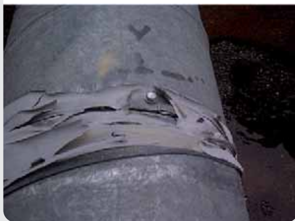
Photo 6 : Adhésifs détériorés sur conduits extérieurs
