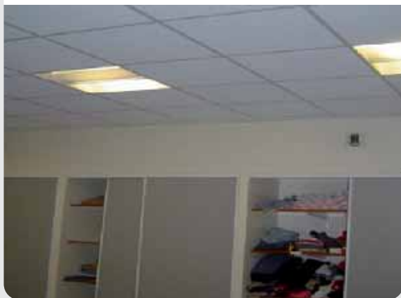
Photo 13 : Bouches d'extraction d'air dans un dortoir
