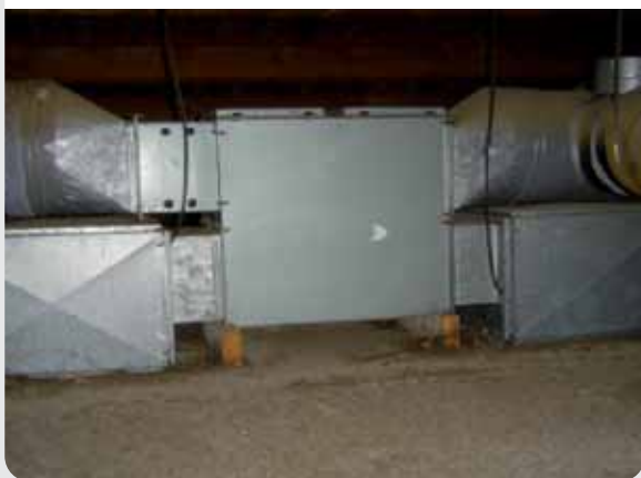
Photo 1 : Centrale double flux dans des combles
