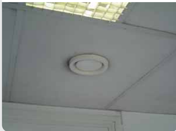
Photo 10 : Bouche de soufflage d'air dans une cantine
