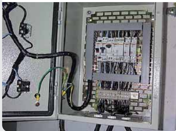
Photo 16 : Armoire électrique - recherche horloge
