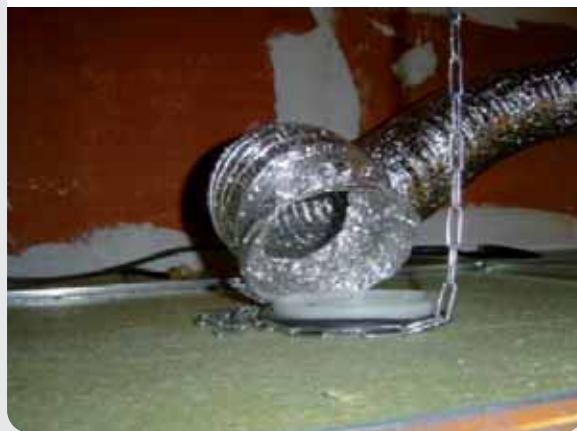
Photo 12 : Bouche déconnectée au dessus du plafond
