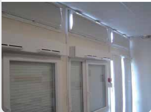
Photo 9 : Entrées d'air dans un dortoir
