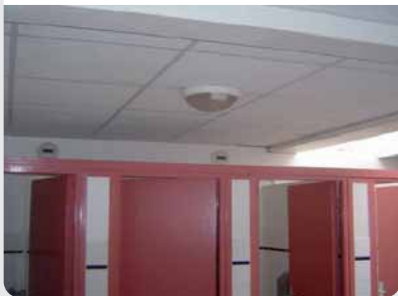
Photo 11 : Bouches d'extraction dans des sanitaires
