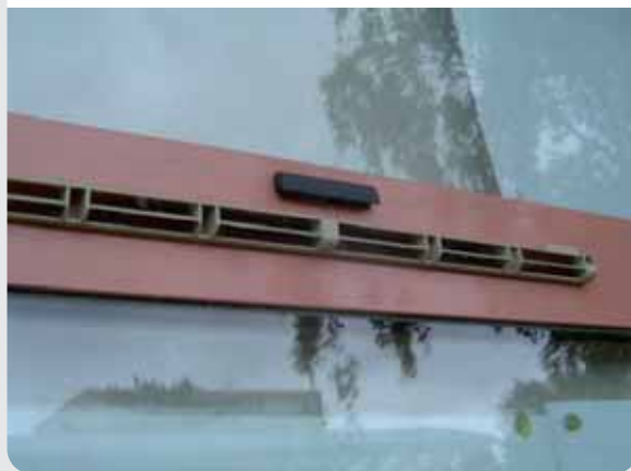
Photo 8 : Entrée d'air dans une fenêtre
