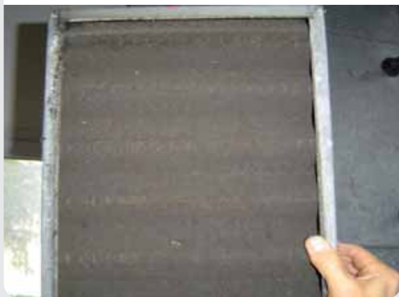
Photo 15 : Filtre de CTA très encrassé
