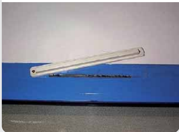
Photo 7 : Entrée d'air avec réservation trop étroite
