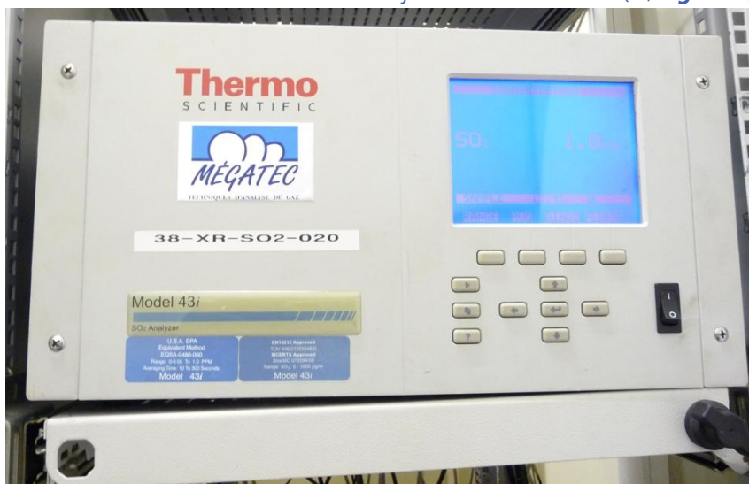
Figure 3 : Analyseur Thermo 43i implanté dans la station SG ( Crédit photo : ©Atmo Réunion).
